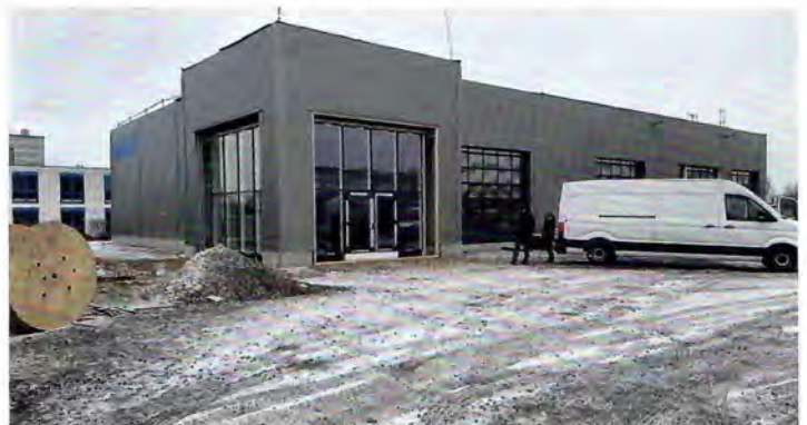
Man sieht, was es einmal werden soll: Die Außenpaneele sind montiert, Tore und Fenster ebenso. Stand: Mitte Januar 2023.
